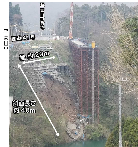
写真-1:被災状況写真(令和2年4月10日対岸より)
