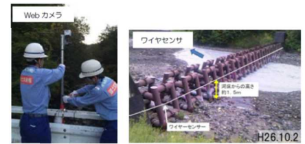
図-9 他火山における緊急ソフト対策としての機器設置イメージ
