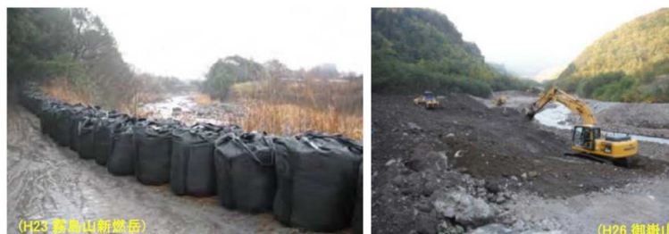
図-7 他火山における緊急ハード対策のイメージ（左：導流堤，右：治山堰堤堆砂敷の除石工事）
