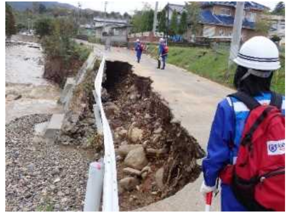
写真-2 河川班被災状況調査の実施状況（長野県佐久穂町）
