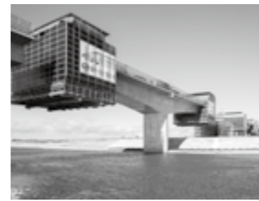
■北陸新幹線、手取川橋りょう 手取川橋りょうは、北陸新幹線の延伸区間（金沢～敦賀）の工事のうち、石川県内の最大河川である手取川で施工している橋梁で、北陸新幹線の敦賀延伸区間で最大となる全長558mの橋梁です。
