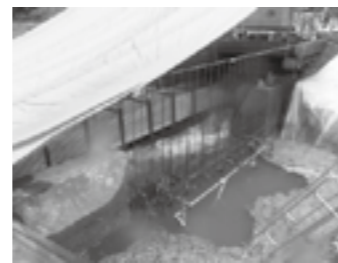
7月26日のボックス部被災状況 ▶P.9
