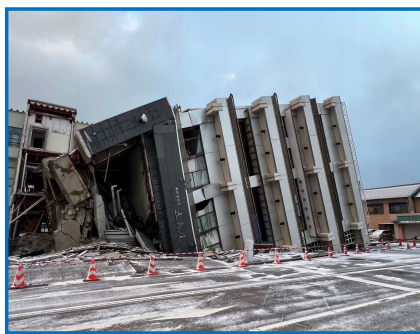
能登半島地震によるビル倒壊 （輪島市河井町）
