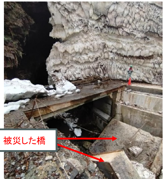
写真-1: 大量の積雪により落橋
