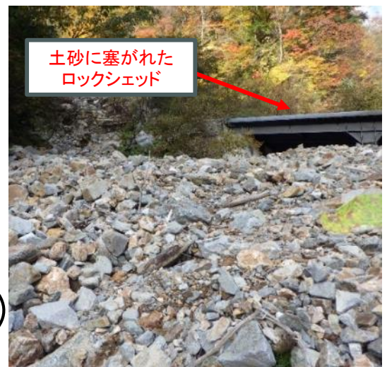
写真-2: 大量の土砂流出により道路が閉塞
