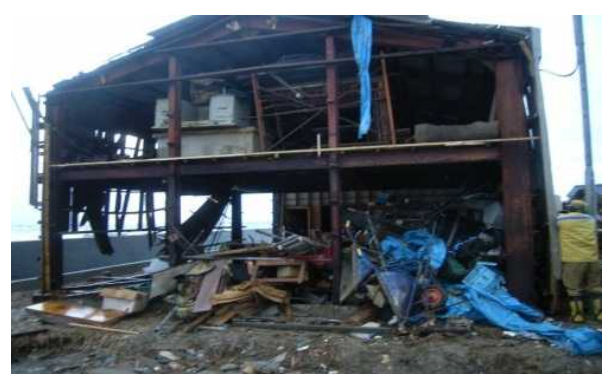
住家の破壊状況 (黒部市生地地区)
