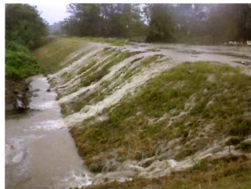
水防活動 を行わないと堤防の決壊など 甚大な被害につながる恐れがあります。
