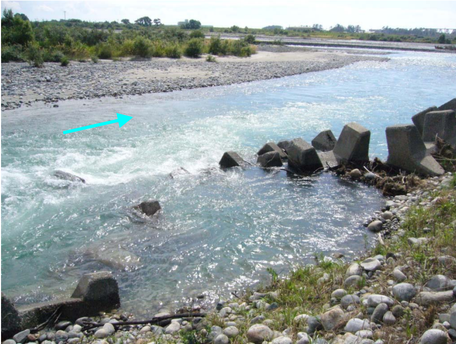
富山県入善町五郎八地先【根固ブロック流失】黒部川
