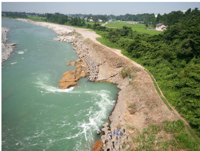
富山市塩地先【護岸流失】神通川
