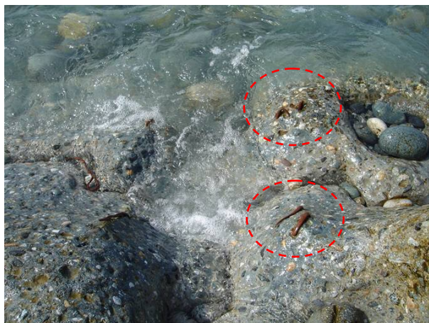
NO, 108付近 ブロック摩耗による鉄筋露出
