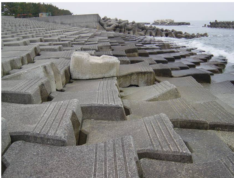
NO. 171+70 緩傾斜堤ブロックの沈下・隆起
