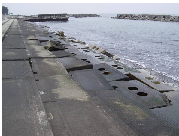
NO, 111付近 ブロック隆起・沈下状況
