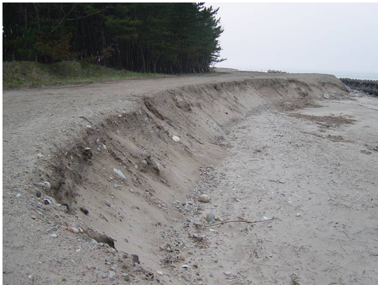
NO. 16より東方向 養浜侵食状況
