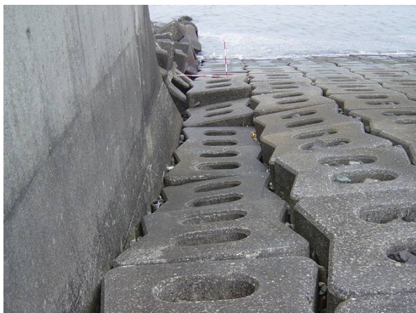
NO, 182+10 緩傾斜堤ブロック沈下
