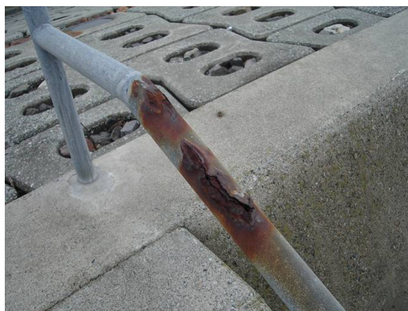
NO, 182+20 入口階段手摺の錆
