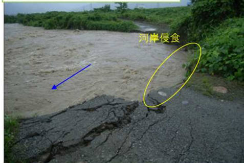
7.4k左岸（H29.7出水）7/3 14:40確認
