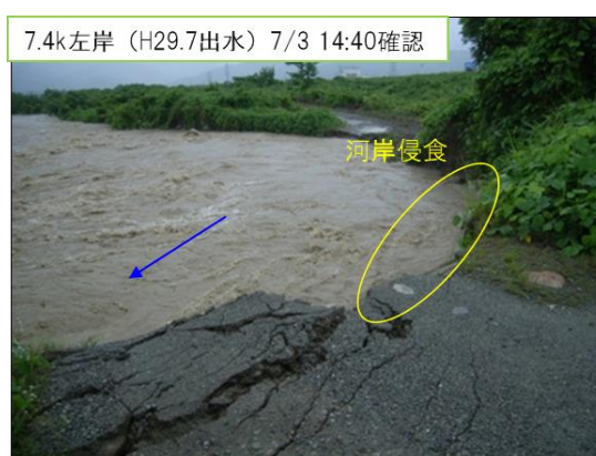
図 3-9 小規模洪水による河岸侵食
