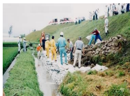
写真 3-2 漏水による被災箇所 (平成7年（1995年）7月洪水)
