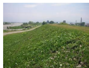
写真 3-11 堤防に繁茂するクズ
