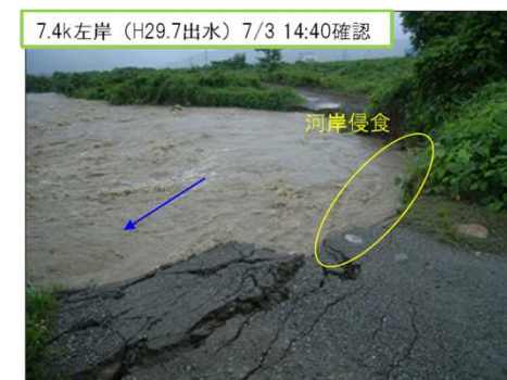
H29 (2017).7洪水での被災状況
