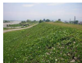
写真 3-12 堤防に繁茂する葛 (左岸 0.8k 付近)
