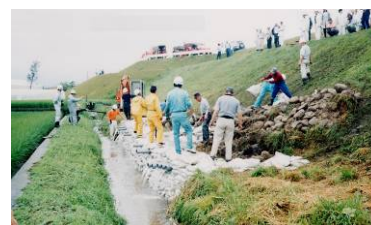
写真 3-2 漏水による被災箇所 （平成 7 年 7 月洪水）
