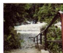
●土砂に埋った猿飛峡遊歩道
