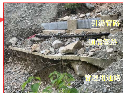
写真-3 損傷状況
