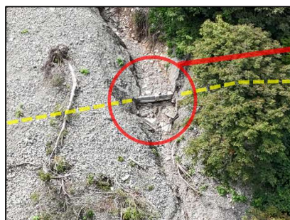
写真-2 通路損傷箇所
