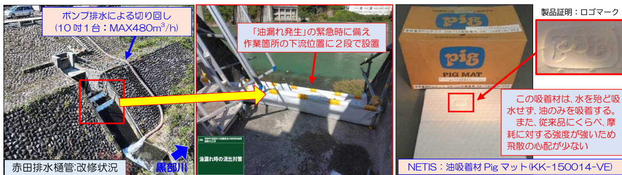
写真7 油漏れ発生時の流出防止対策（作業中における水路内の常設設備）
