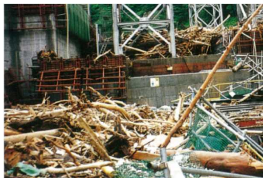
H7年洪水時の流木 (宇奈月ダム工事現場)
