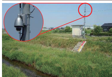
河川監視カメラ設置状況
