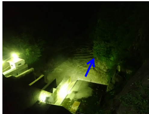
【出し平ダム下流】自然流下開始時 (EL. 306.24m) 7月2日 2:40撮影
