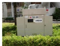
非常用発電機
