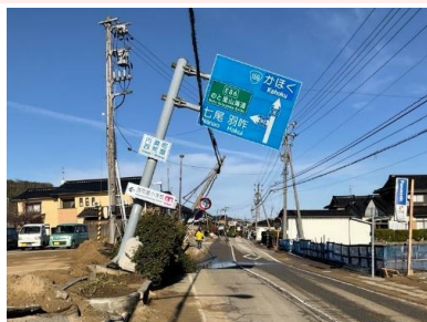
令和6年能登半島地震液状化被災状況 (石川県内灘町)
