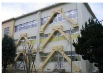
耐震ブレースによる建物の耐震化
