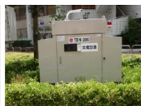
非常用発電機
