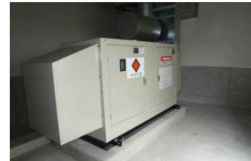
非常用自家発電設備
