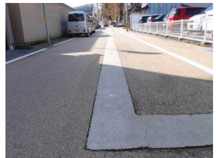
◆宇出津 1 号線 整備状況(消雪装置)
