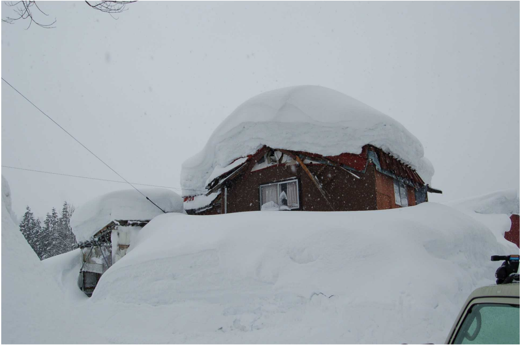
山古志地域の空き家（積雪により損壊）
