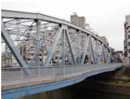
【高欄】 アルミ製で、材質本来のシルバー色となっている。現状では腐食等の問題は発生していない。
