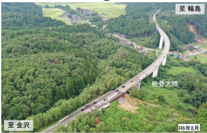
写真：能登大橋付近 盛土崩落箇所
