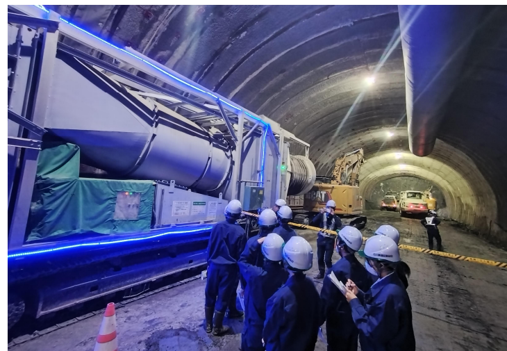
森本TN 重機、設備の説明 (左が集塵機、右上が送風機)
