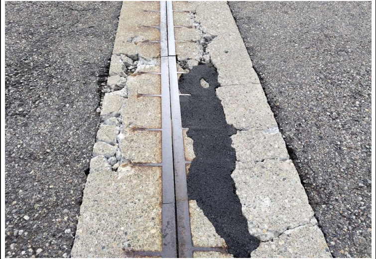
橋梁の損傷状況
