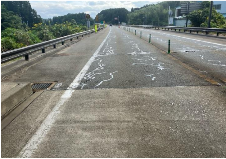
舗装の損傷状況
