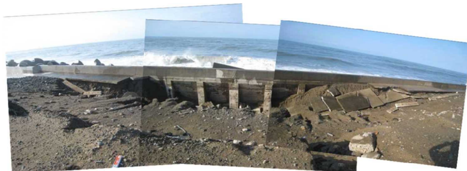
海岸堤防被災のイメージ（平成22年1月 冬季風浪による小松地区の被災事例）
