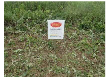
注意標示の破損
