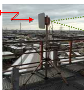
◇無線装置(仮設)
