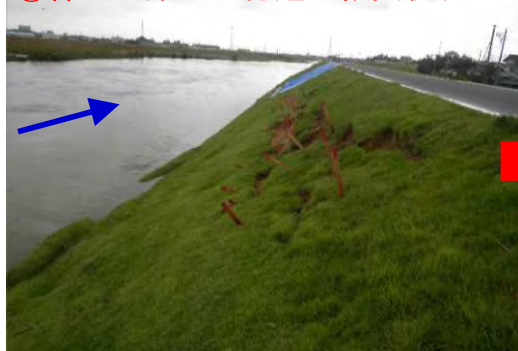
①梯川右岸5.7k付近の被災状況
