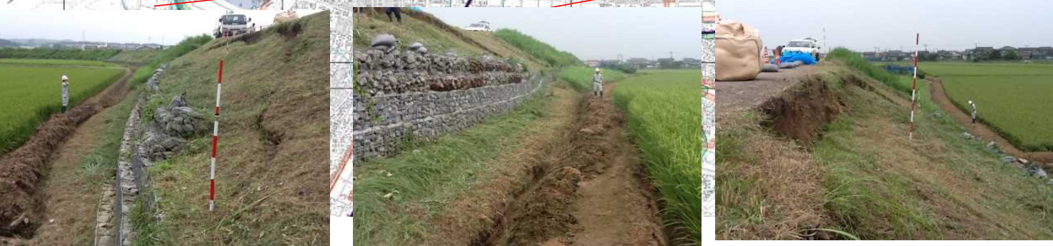
④梯川右岸8.4k付近の被災状況
