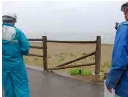
海岸保全施設 白山市八田地先の落下防止木柵の損傷
