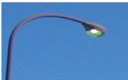
水銀ランプ(交換前)
