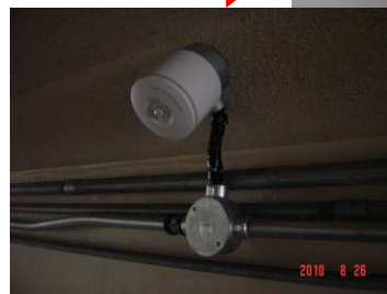
人感センサー設置状況
