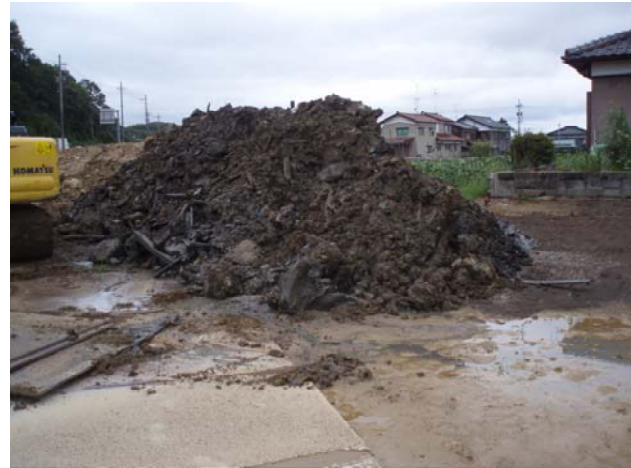
②掘り出された廃棄物
