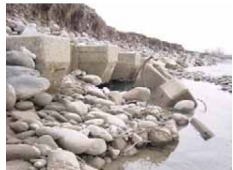
図 29 洪水による河岸侵食状況 (平成 16 年 10 月 20 日台風 23 号出水被災箇所 川北町舟場島地先 右岸 4.6K 付近)
