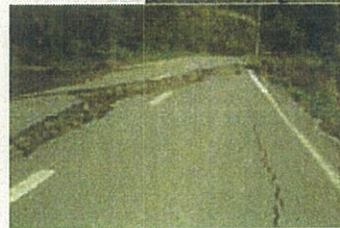
中越地震道路被災状況
