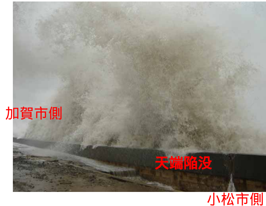
沈下状況写真(H17.11.30PM撮影) 【小松市安宅新地先】
