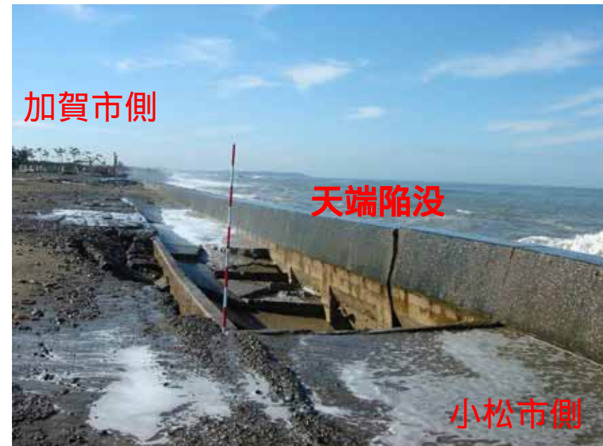
被災狀況写真(H17.12.1AM撮影) 【小松市安宅新地先】
