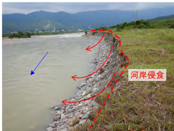
能美市灯台笹地先の河岸侵食
