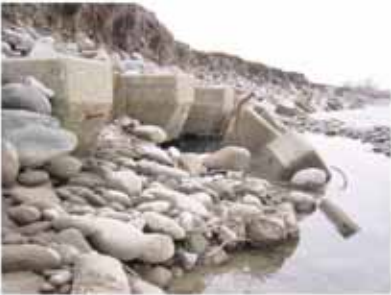
図 28 洪水による河岸侵食状況 (平成 16 年 10 月 20 日台風 23 号出水被災箇所 川北町舟場島地先 右岸 4.6k 付近)
