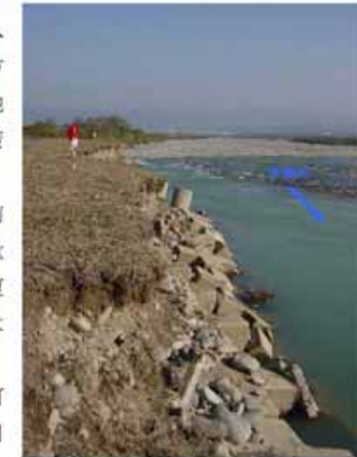
図 41 洪水による河岸侵食状況 （H16. 10. 22 出水被災箇所 手取川右岸 4.6K 付近）
