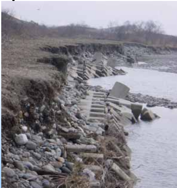
H16.10.20台風23号出水での侵食状況 川北町舟場島地先 右岸5.0k付近
