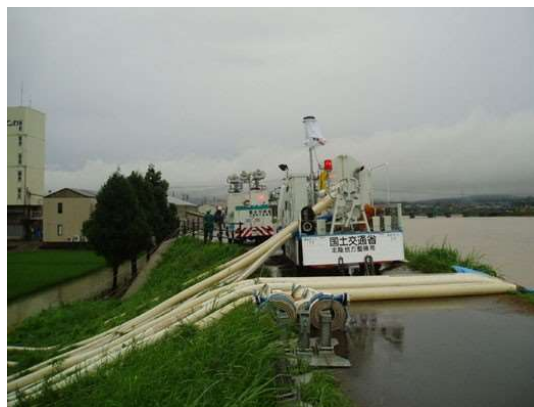
図 9-8 川田川樋管排水ポンプ車
