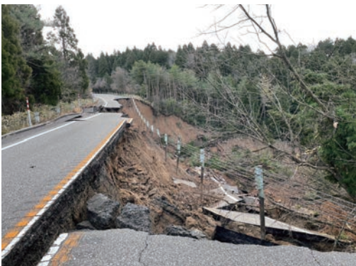
被災状況 (12.1kp七尾市中島町谷内地先)
