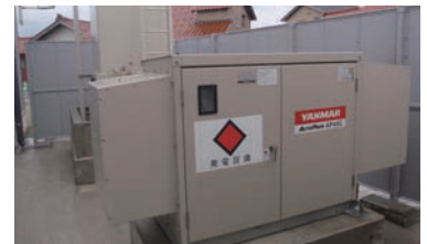
防災施設（自家用発電機）
