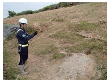
堤防点検により堤防の変状を確認
