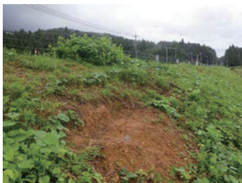
河川巡視で発見したイノシシによる堤防の損傷
