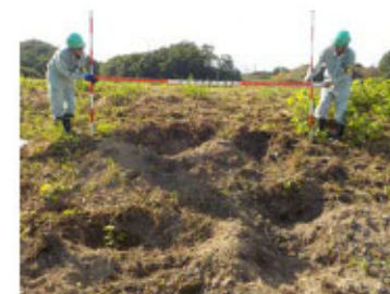
イノシシの掘り返しによる堤防の損傷
