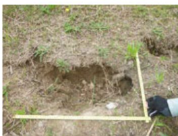
キツネの巣穴による堤防の損傷
