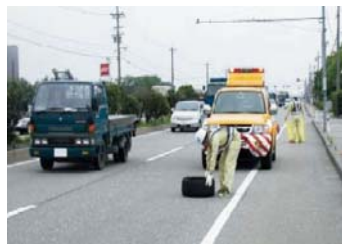
パトロールで発見した 落下物の回収
